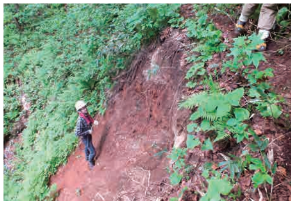
写真20 路肩が崩れかけている危険箇所。注意を呼びかける教員。
